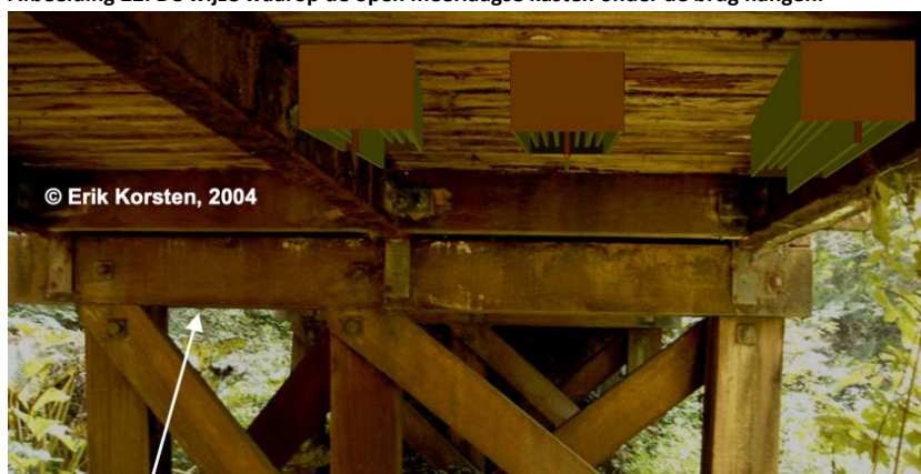
Afbeelding 22. De wijze waarop de open meerlaagse kasten onder de brug hangen.
